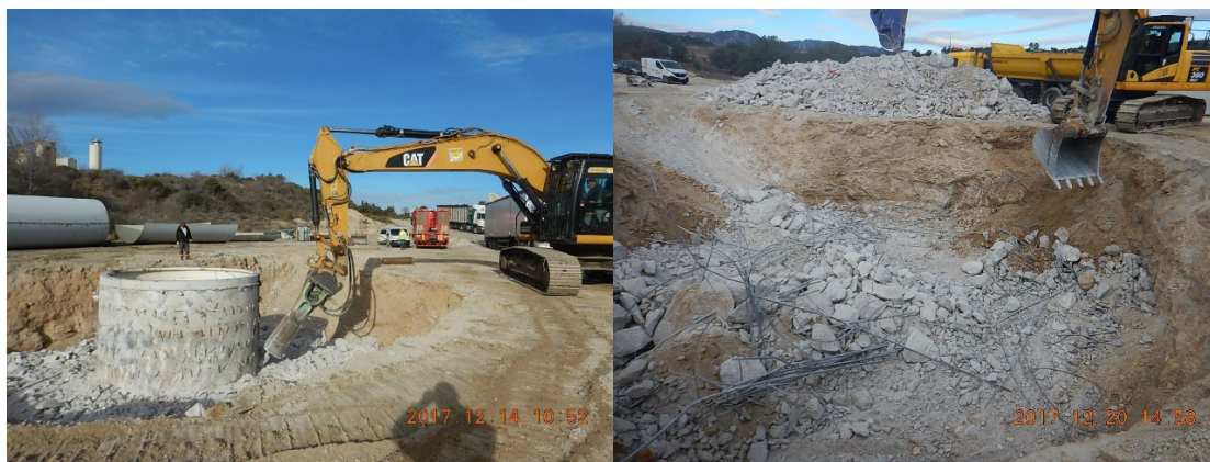
Figure 3- Destruction de la fondation
